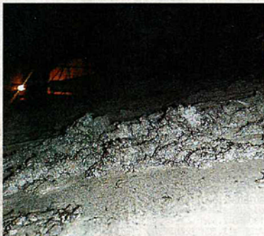
渋谷公会堂の天井裏に雪のように積もった石綿。アスベストセンター提供
